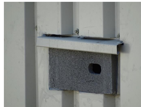
Nichoir en façade d'un bâtiment industriel
