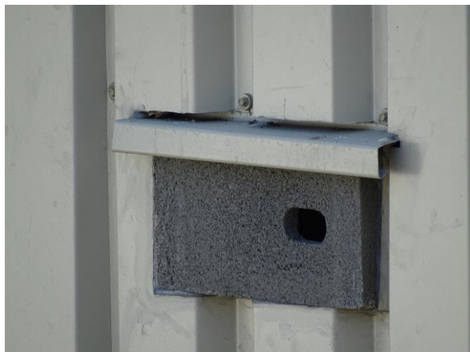
Nichoir en façade d'un bâtiment industriel
