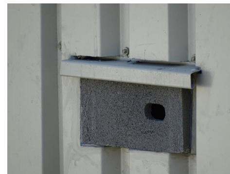
Nichoir en façade d'un bâtiment industriel
